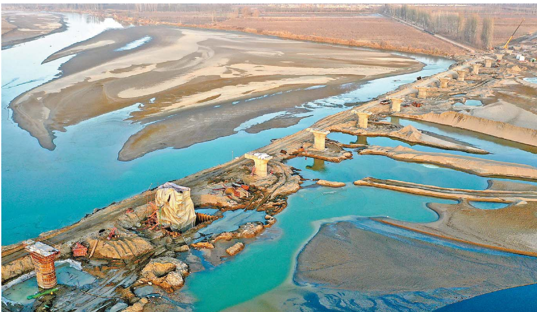
11 - ئاينىڭ 26 - كۈنى، قۇرۇلۇشچىلار ئاقسۇ دەرياسى تۆمۈرىيول ئالاھىدە چوڭ كۆۋرۈكى تۈرى نەق مەيدانىدا قۇرۇلۇش قىلماقتا. قىش كىرگەندىن كېيىن، قۇرۇلۇش خادىملىرى بىرىنچى سەپتە چىڭ تۇرۇپ، قۇرۇلۇش مۇددىتىنى چىڭ تۇتتى. ئاقسۇدىن ئارالغىچە بولغان تۆمۈرىيولدا بۇ يىلى 4 - ئايدا قۇرۇلۇش باشلانغان بولۇپ، مۆلچەرلىمەشچە كېلەر يىلى 6 - ئاينىڭ ئاخىرى قۇرۇلۇش پۈتۈندىگەن. □ ۋاڭ جىچىڭ فوتوسى
